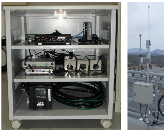
図 3 ADS-B 受信システム (高松空港事務所)
