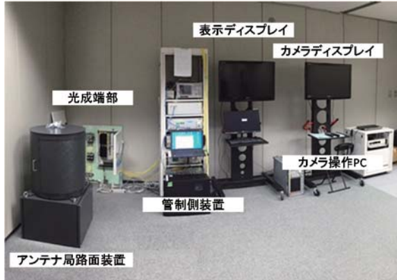
図 3 中央局（管制側装置）およびアンテナ局（路面装置）概観
