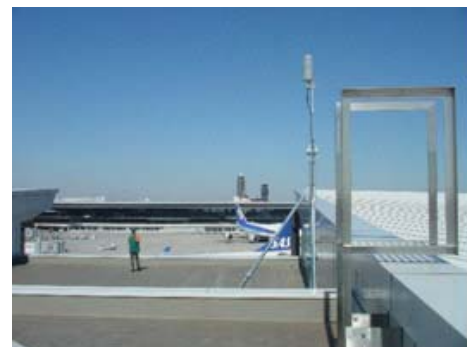
図6 受信局アンテナの設置例
