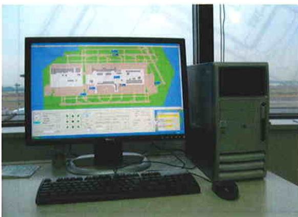
図8 監視モニタ表示装置外観
