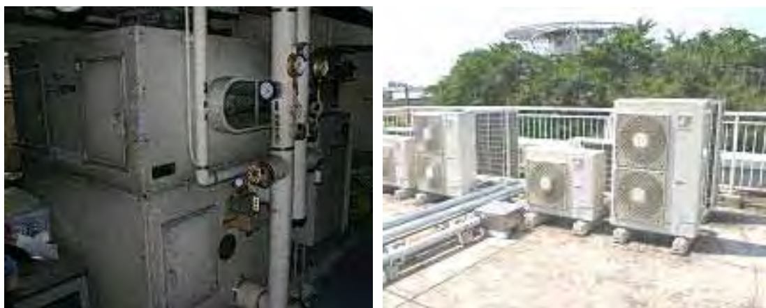
図 14 重油利用空調機（左）と個別式空調機
