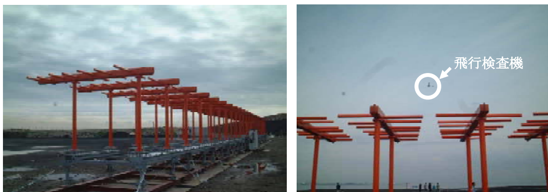
図 30 仮設置されたローライザー・アンテナ（左）と実験中の飛行検査機（右）
