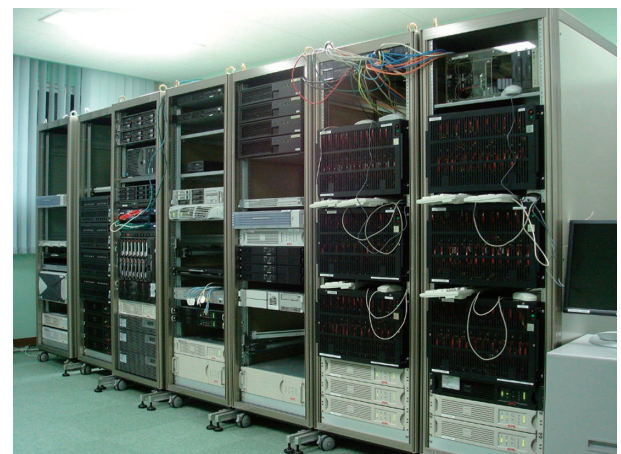
図1 補正情報リアルタイム生成・配信システム外観
