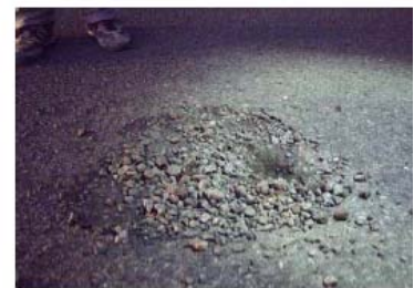
アスファルトと骨材が結合分離した滑走路
