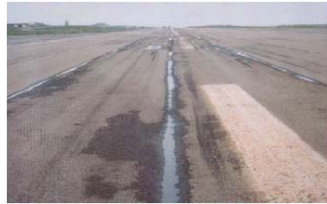
空港舗装は潜在的に水に弱い要因を有している
