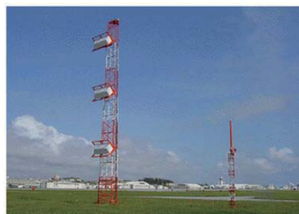
ILSグライドパスアンテナとターミナルDMEアンテナ
