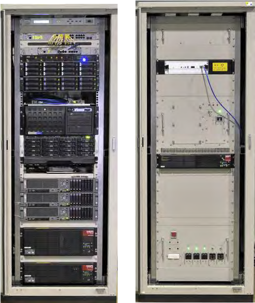
左:レーダ処理装置 (データ処理・監視制御・表示)
