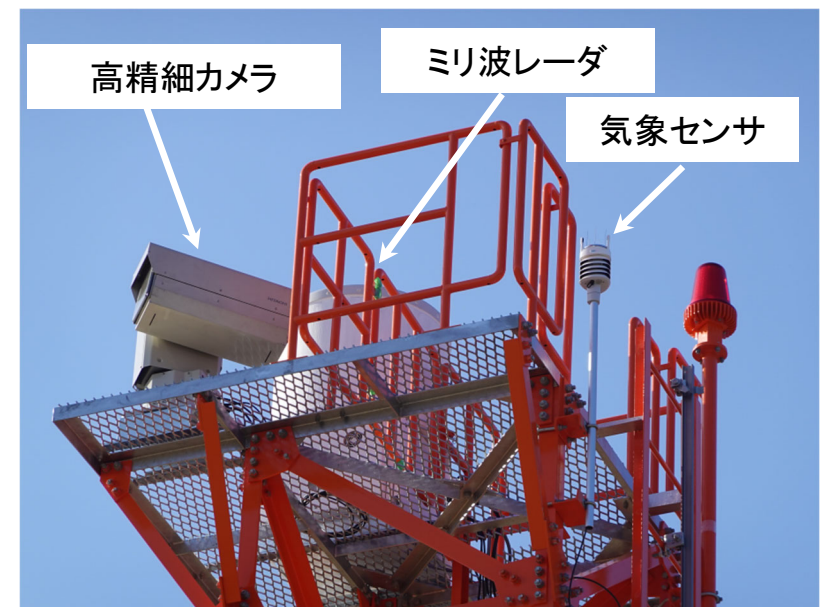
滑走路異物監視システム鉄塔概観
