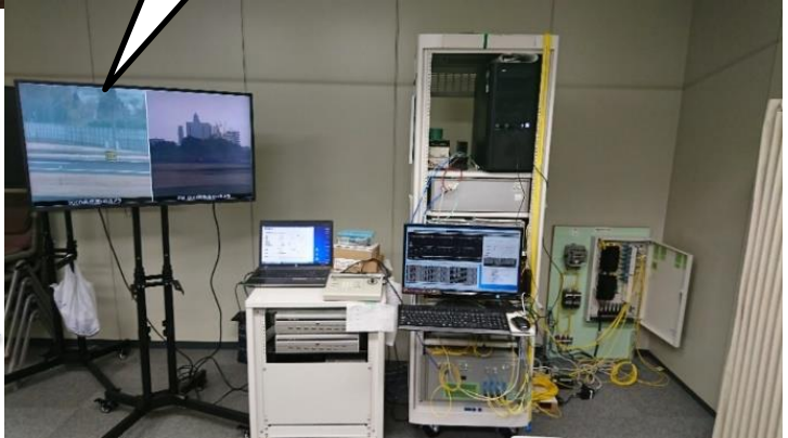
空港ビル（中央装置）
