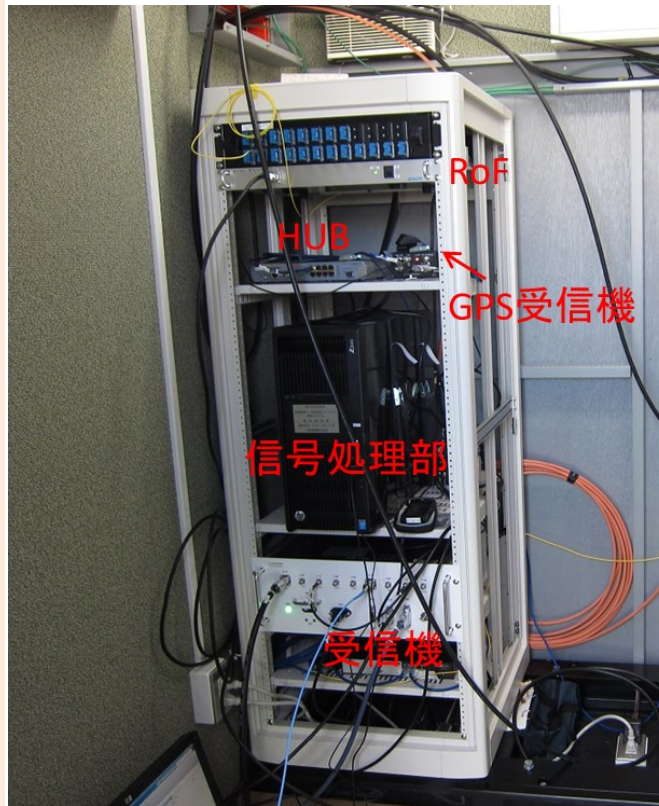
OFC-PPSR実験装置
