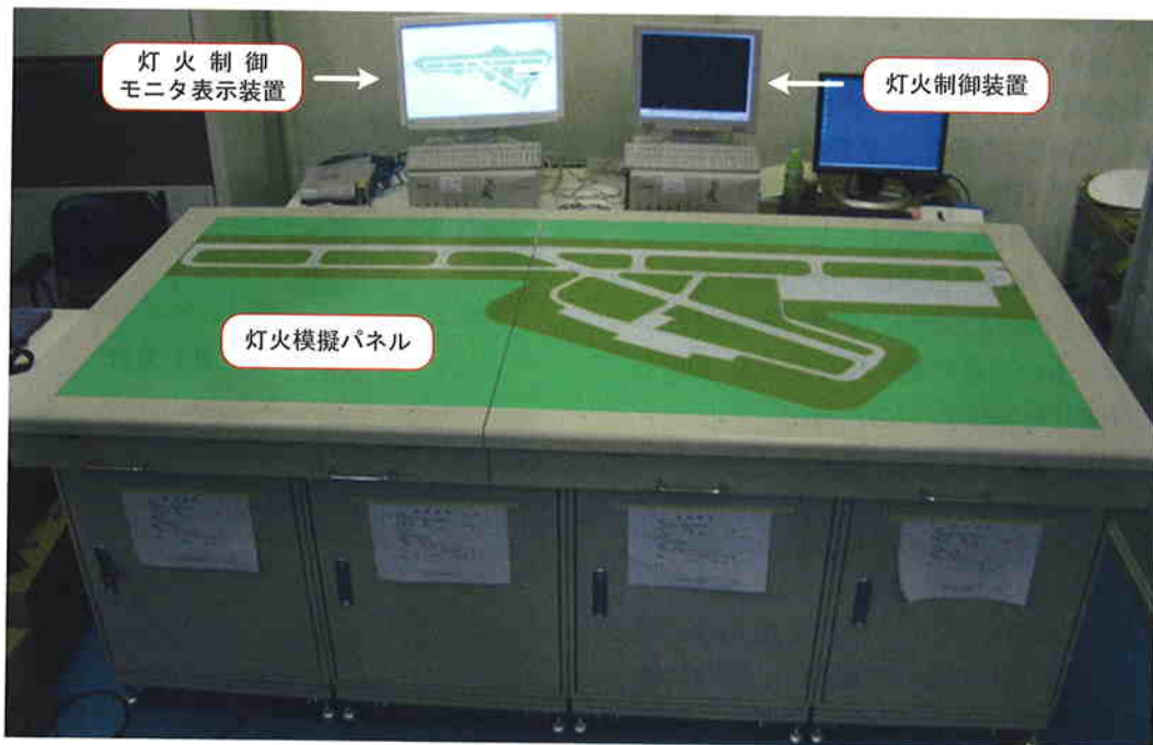
図11 灯火制御装置、灯火制御モニタ表示装置、灯火模擬パネル外観
