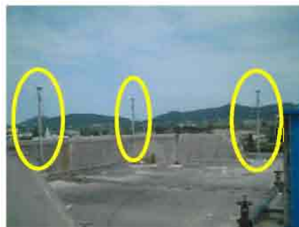
図 4 アンテナ設置状況（中央運動公園）
