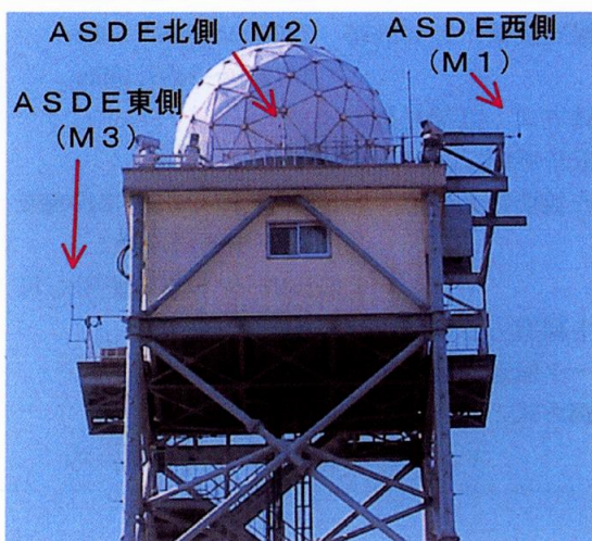
図6 ASDE鉄塔アンテナ設置外観
