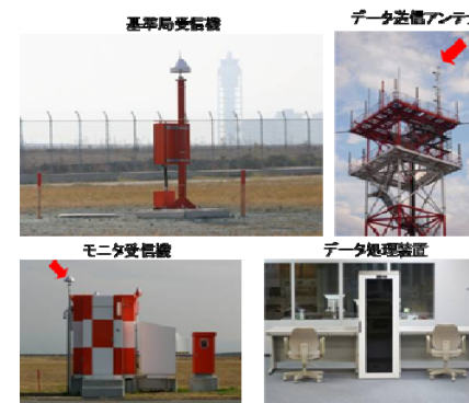
GBASプロトタイプ実験装置(関西国際空港)
