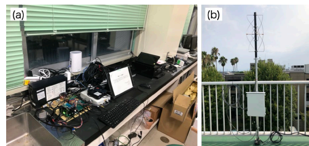
図 1. (a) 鹿児島高専に設置した受信機と (b) アンテナ。
