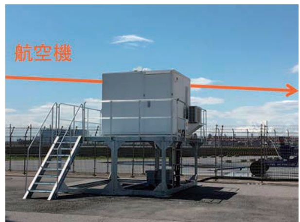
図 3. 羽田空港に設置した LiDAR 装置
