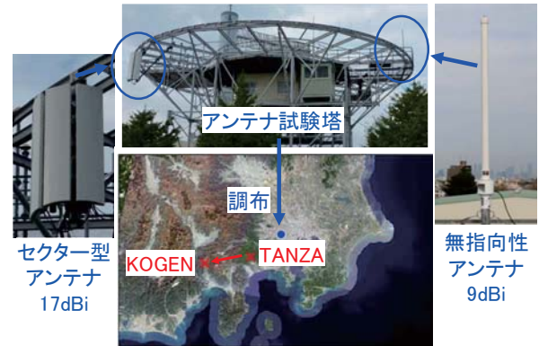
図3 アンテナ設置状況と受信局の位置関係
