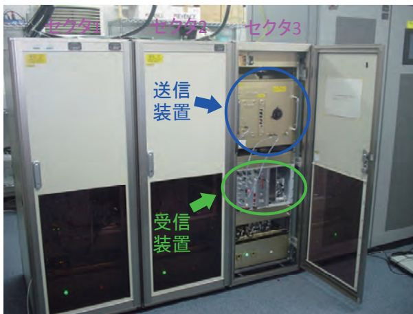
図7 セクタ型アンテナ用送受信局の外観
