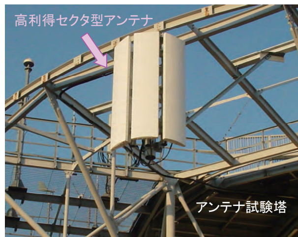
図3 高利得セクタ型アンテナの設置状況
