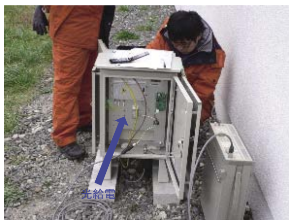
図6 光給電を実装した受信ステーションの外観
