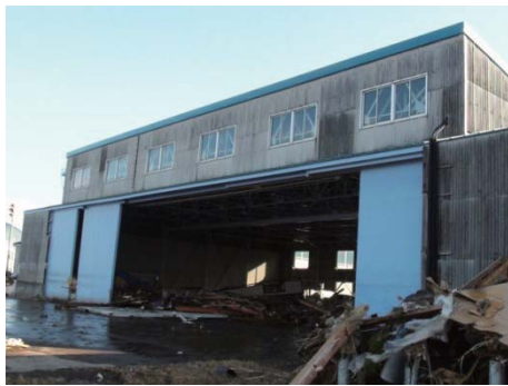
被災後の格納庫（正面）
