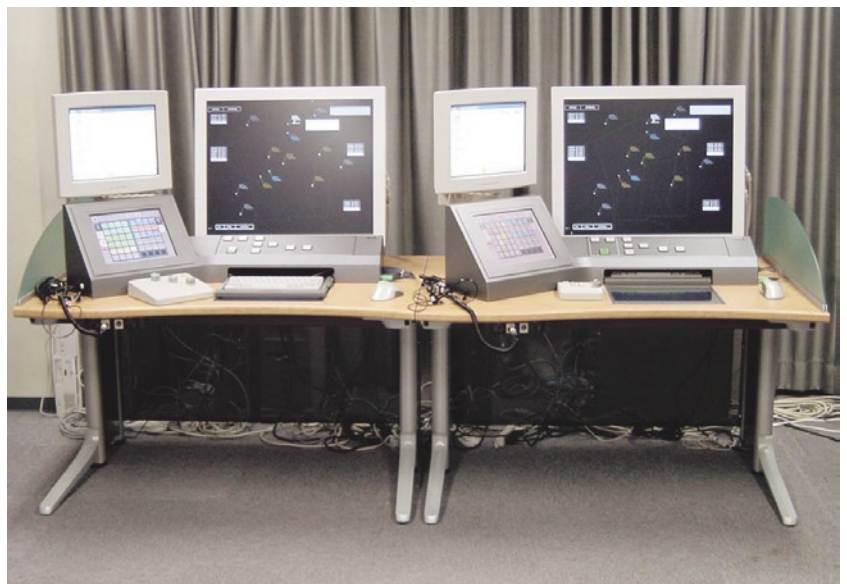
図1 レーダ管制業務用ワークステーション
